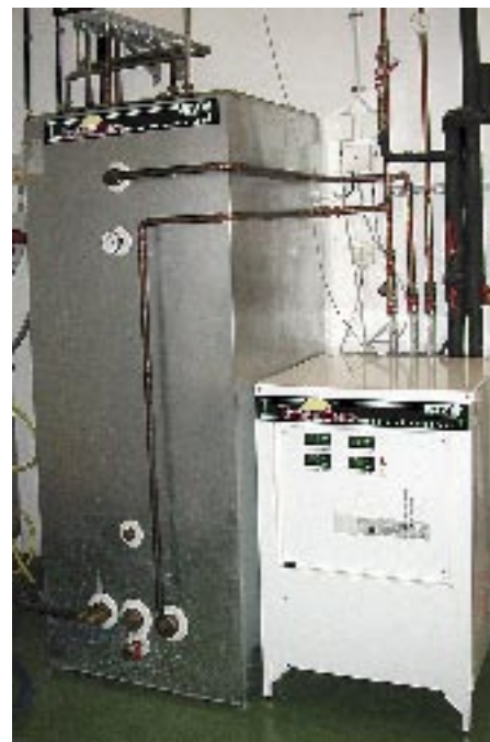
I pannrummet finns värmepumpen och varmvattenbehållaren.
