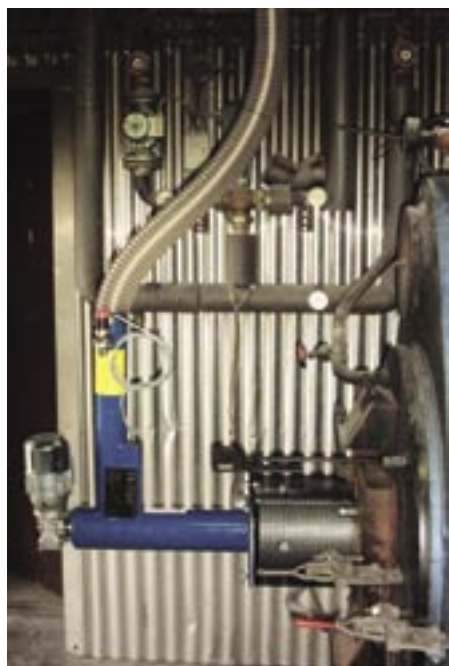
Havrebrännare monterad i panna.
