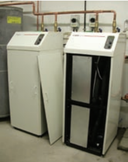
Ovan: Värmen tas från gödselrännorna och förädlas i värmepumpar.
