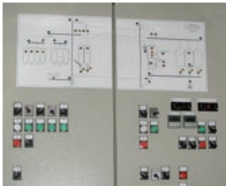
Elcentralen vid våtfickorna.
